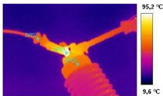
Ossidazione di una connessione di un isolatore
