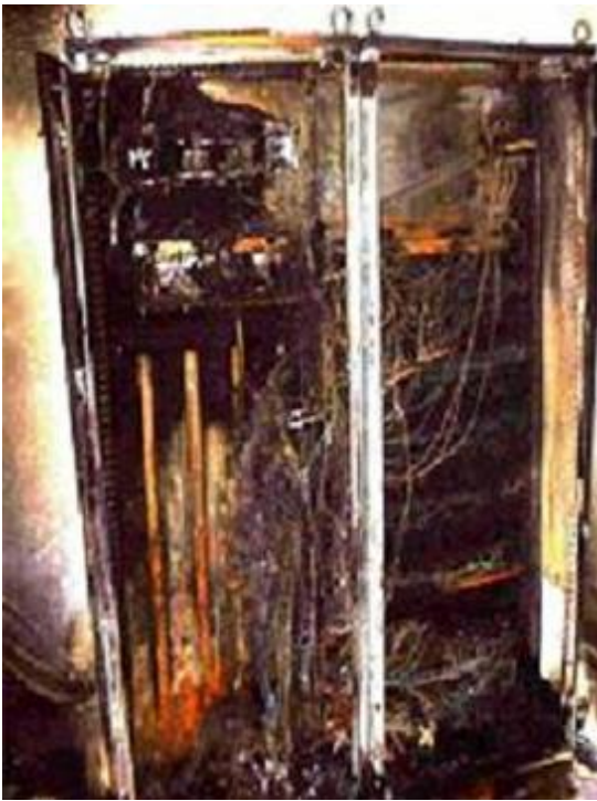
Fig.7: Incendio in un quadro elettrico
